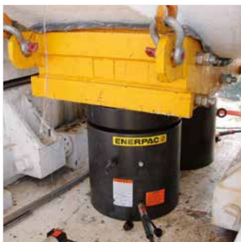
▲ Levantamento pesado e nivelamento de fundações. A porca trava oferece sustentação mecânica da carga por um longo período de tempo.
