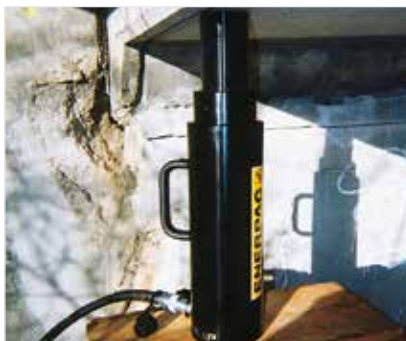
◀ O cilindro portátil com porca trava RACL1506 utilizado como apoio prolongado para a carga, durante uma injeção de epóxi, para reforço de ponte.
